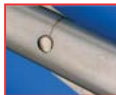
Pukotina na zglobu
